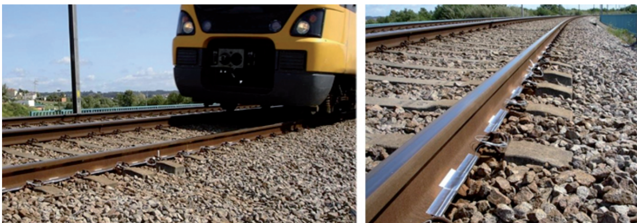
Figura 6. Sensores de Deformación y temperatura instalados en raíles de línea en operación.
